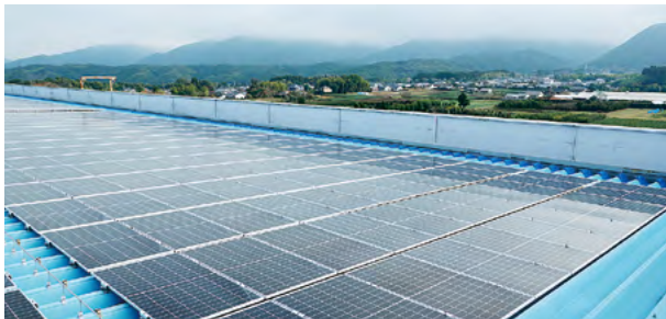
太陽光発電設備
