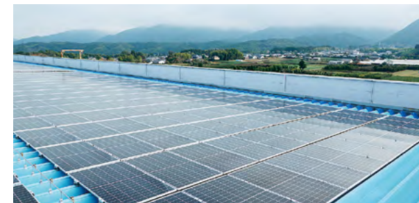
太陽光発電設備
